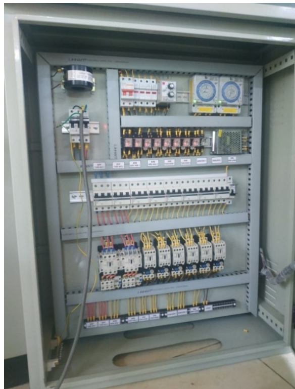
Hình 2.2 Mặt trong của tủ điều khiển
