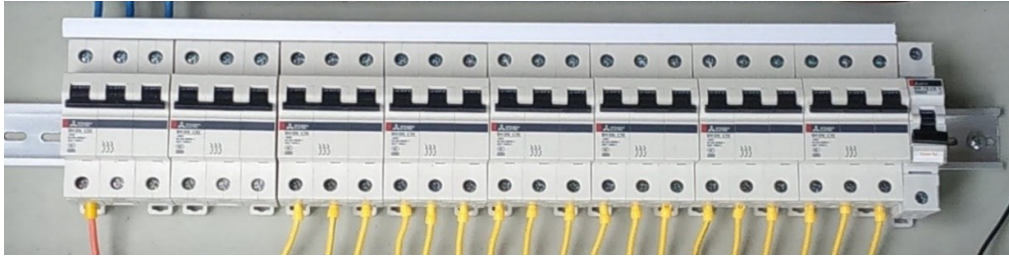
Hình 2.4 MCB cấp điện cho các động cơ
